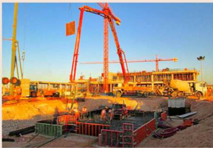
Oca hace la obra civil del tren ligero para la localidad argelina de Ouargla.
